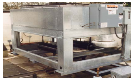
Rooftop Condenser Fan Assembly
